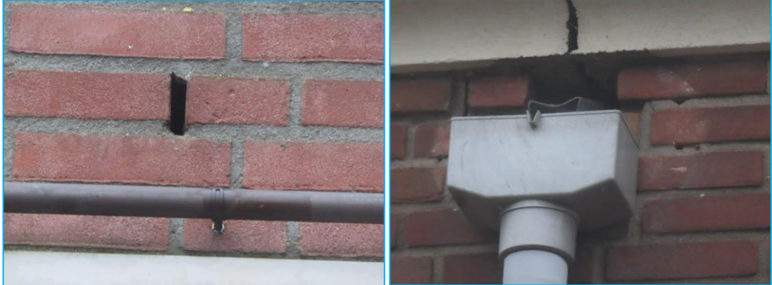
Foto's: Openingen die door vleermuizen gebruikt kunnen worden om bij een eventueel aanwezige verblijfplaats te komen.
