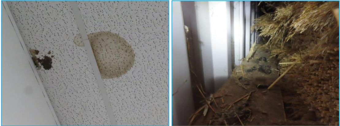
Foto's: Mogelijke sporen van steenmarter in stenen gebouw en vrijstaande kapschuur.
