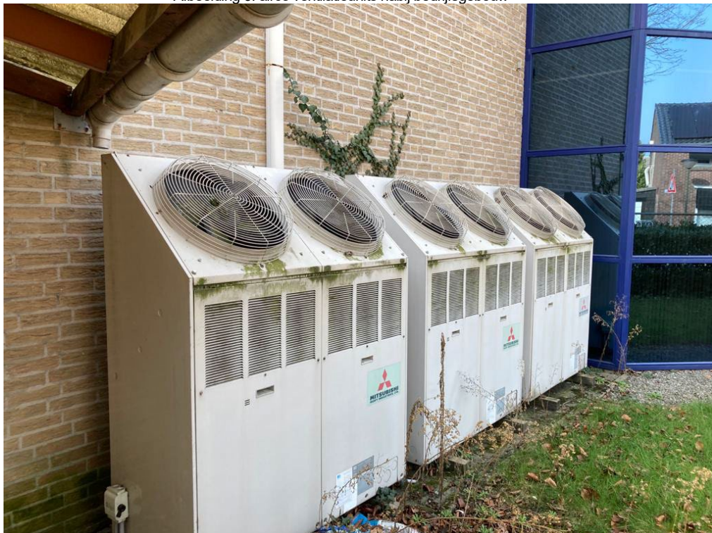
• Afbeelding 9: airco ventilatieunits nabij bedrijfsgebouw
