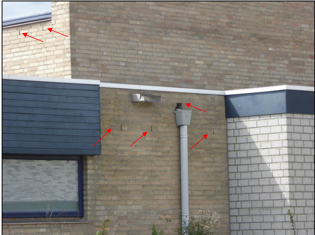
Voorbeelden van open stootvoegen en gaten in de muur van de het gebouw, waardoor vleermuizen de spouwmuur kunnen bereiken.
