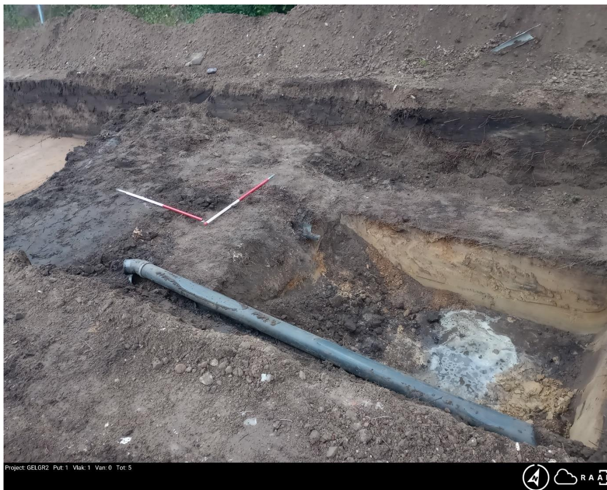
Figuur 7. De plastic leiding die is aangetroffen in WP1.
