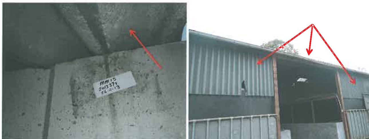
Foto nr. 39 en 40: Golfplaat
