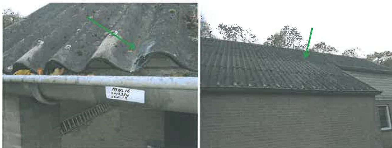
Foto nr. 41 en 42: Golfplaat
