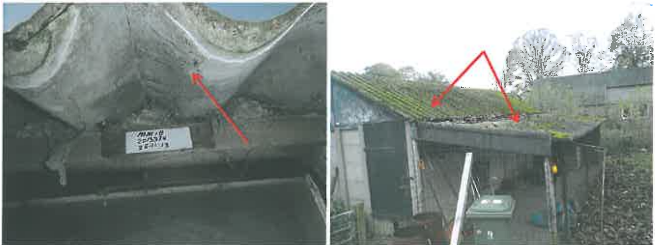
Foto nr. 45 en 46: Golfplaat
