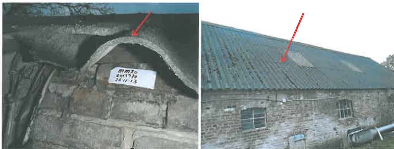
Foto nr. 49 en 50: Golfplaat
