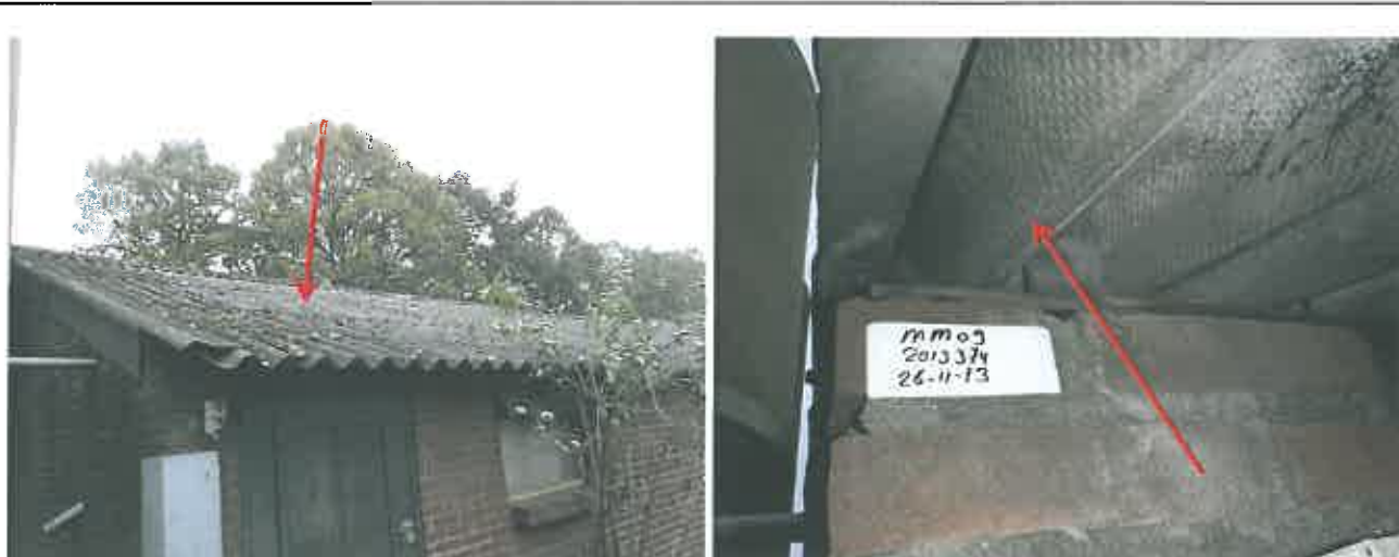
Foto nr. 23 en 24: Golfplaat
