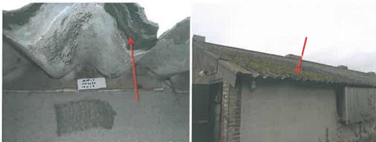
Foto nr. 35 en 36: Golfplaat
