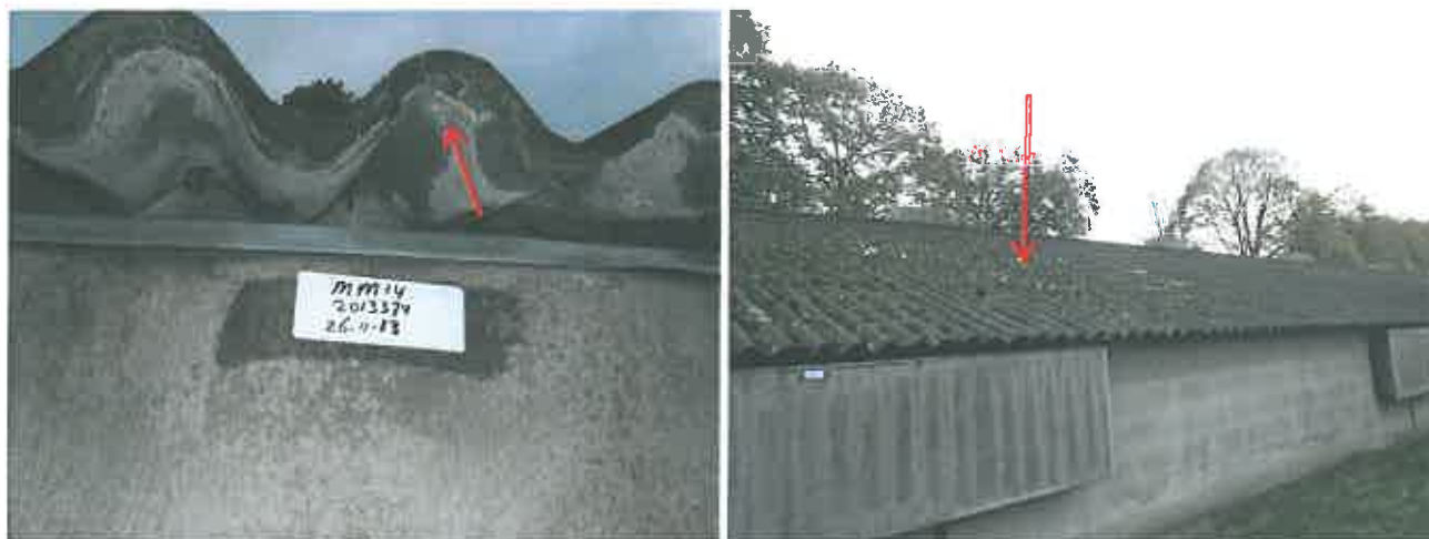
Foto nr. 37 en 38: Golfplaat
