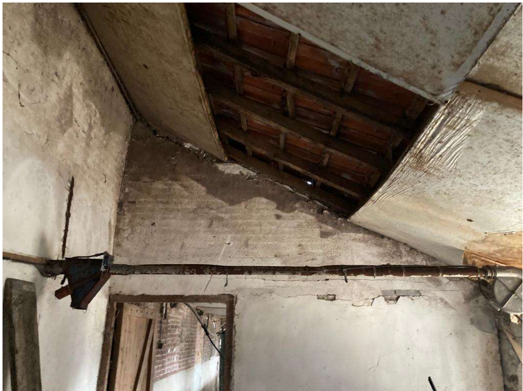
• Afbeelding 20: Binnenzijde aangebouwde schuur, vochtplekken in de muur, kapotte isolatieplaten
