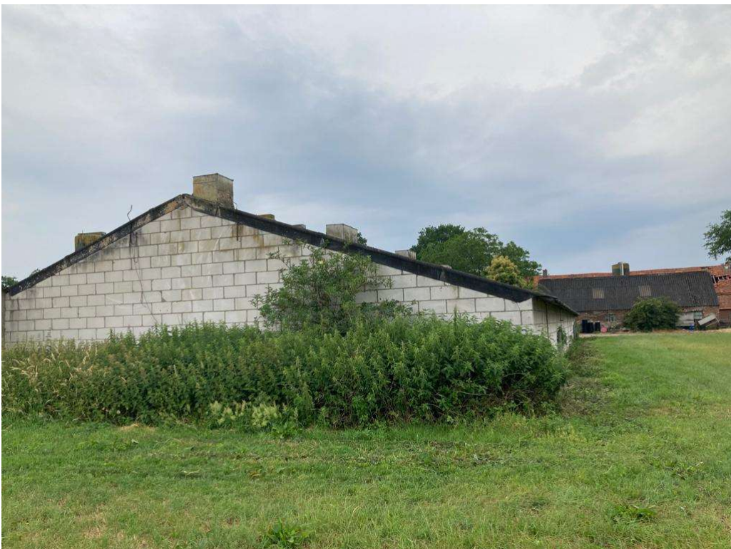
• Afbeelding 10: Achterzijde stal 2 met overwoekerende brandnetel en gemaaid gras
