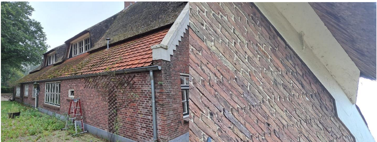
Delen van de woning waarbij te zien is dat de woning geen luchtsponw bevat en delen van de dak overstek niet kieren op het metselwerk.
