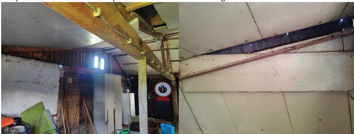
Aangetroffen holle ruimtes achter isolatie
