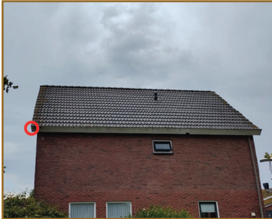
Afbeelding 4: Huismussen nestelen aan de zuidkant van de woning onder de dakpannen. Uiterst links steekt wat nestmateriaal uit dakrand.
