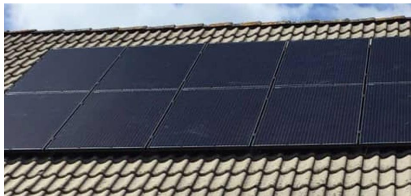
referentie dakpannen met zonnepanelen
