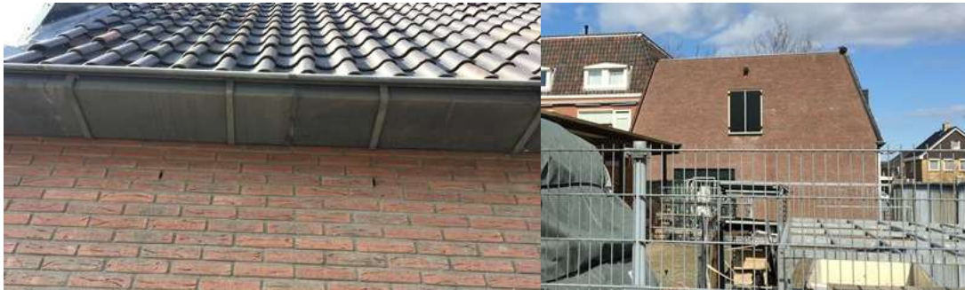
Foto link: open stootvoegen in de oostgevel van het bedrijfspand. Foto rechts: gevelpannen; potentiële invliegopening voor vleermuizen.
