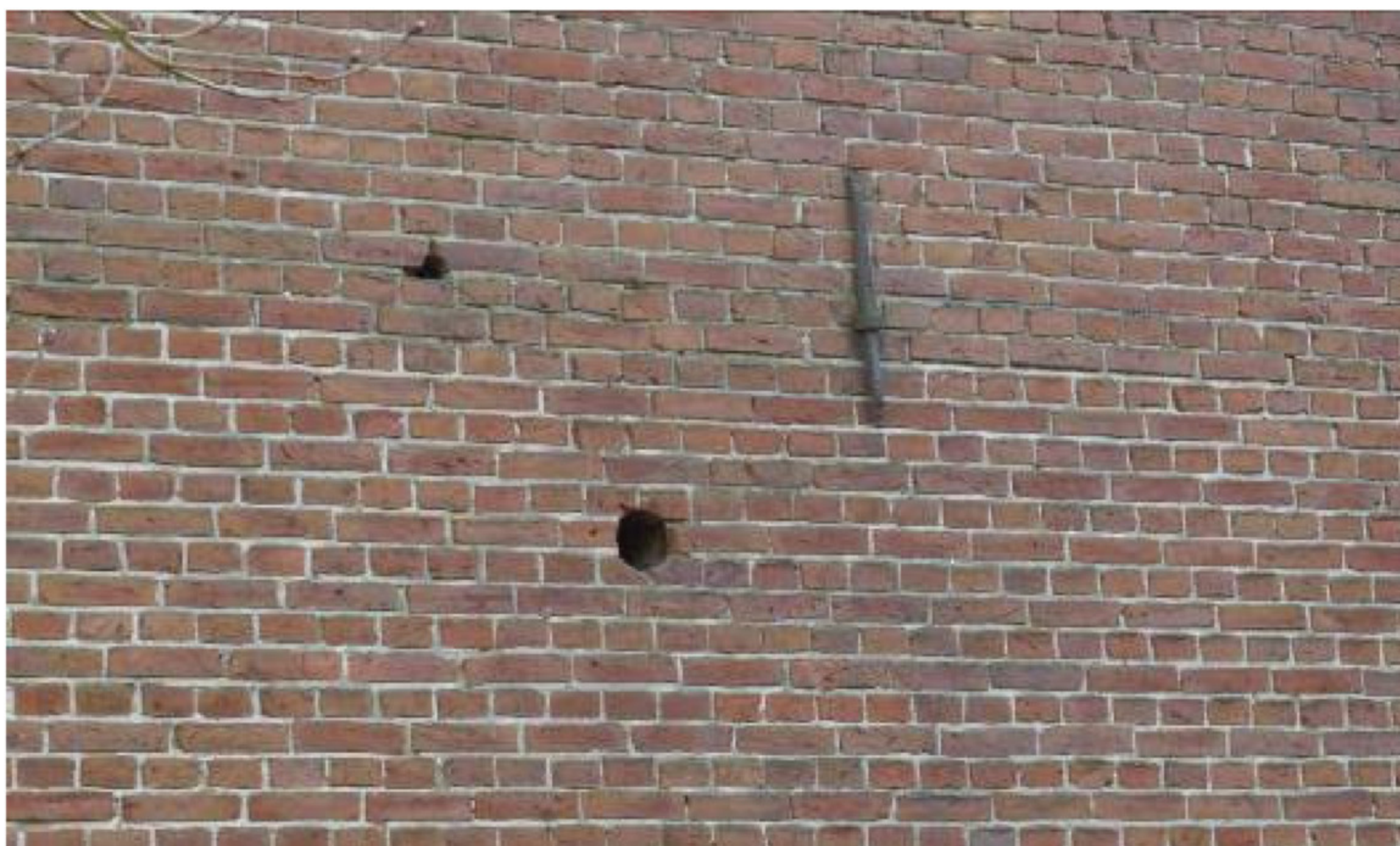
Foto 3.2.4: Voor vleermuizen toegankelijk spouwmuur.
