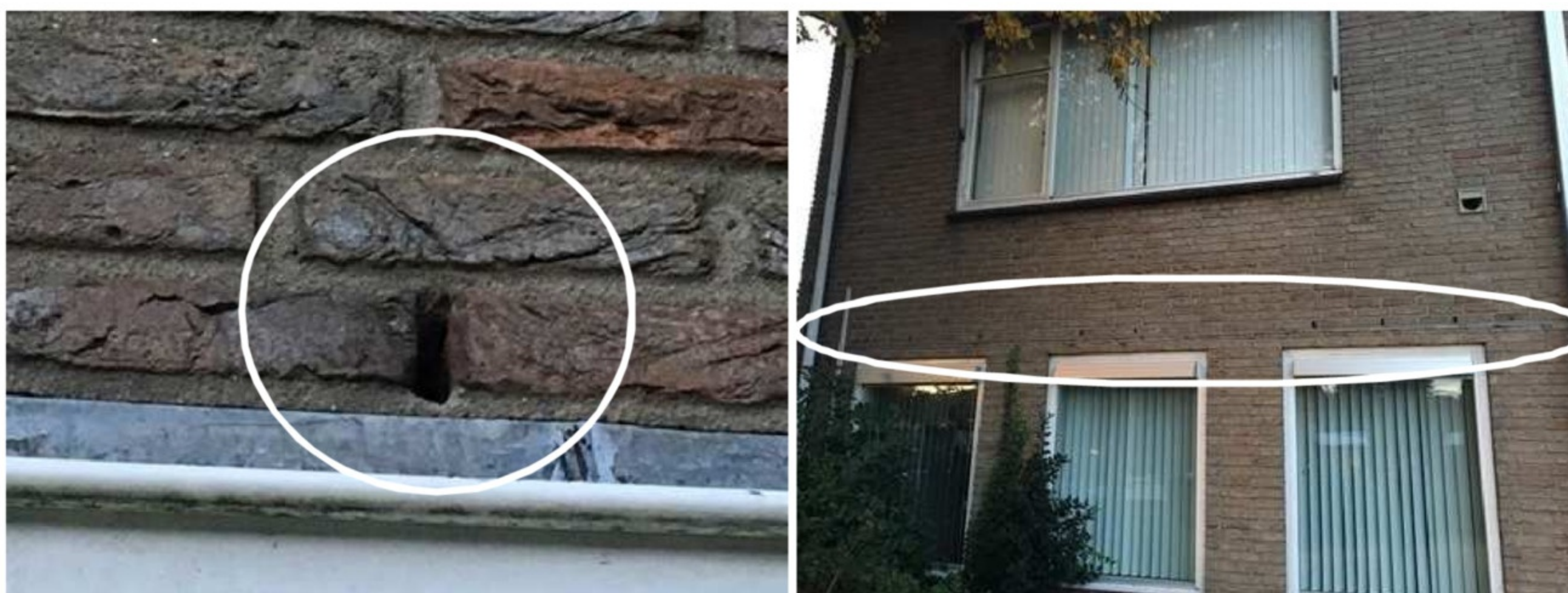
Open stootvoeg in buitengevel van het gebouw. Deze opening lijkt benut te worden door vleermuizen als in- en uitvliegopening.
