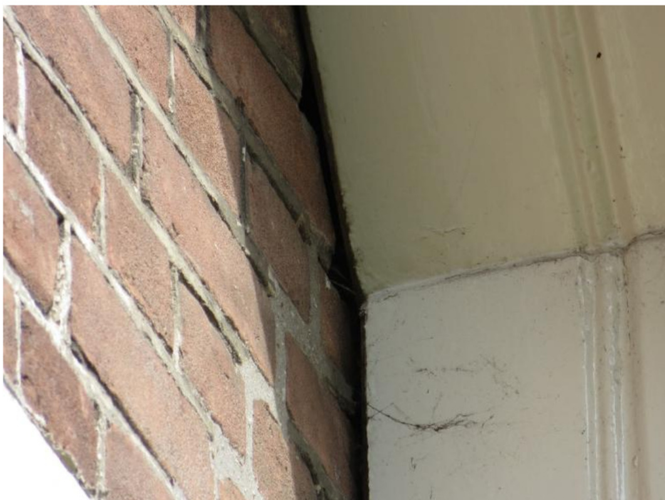
Foto 14: Kieren achter betimmering (gebouw 5), mogelijke toegang voor vleermuizen.
