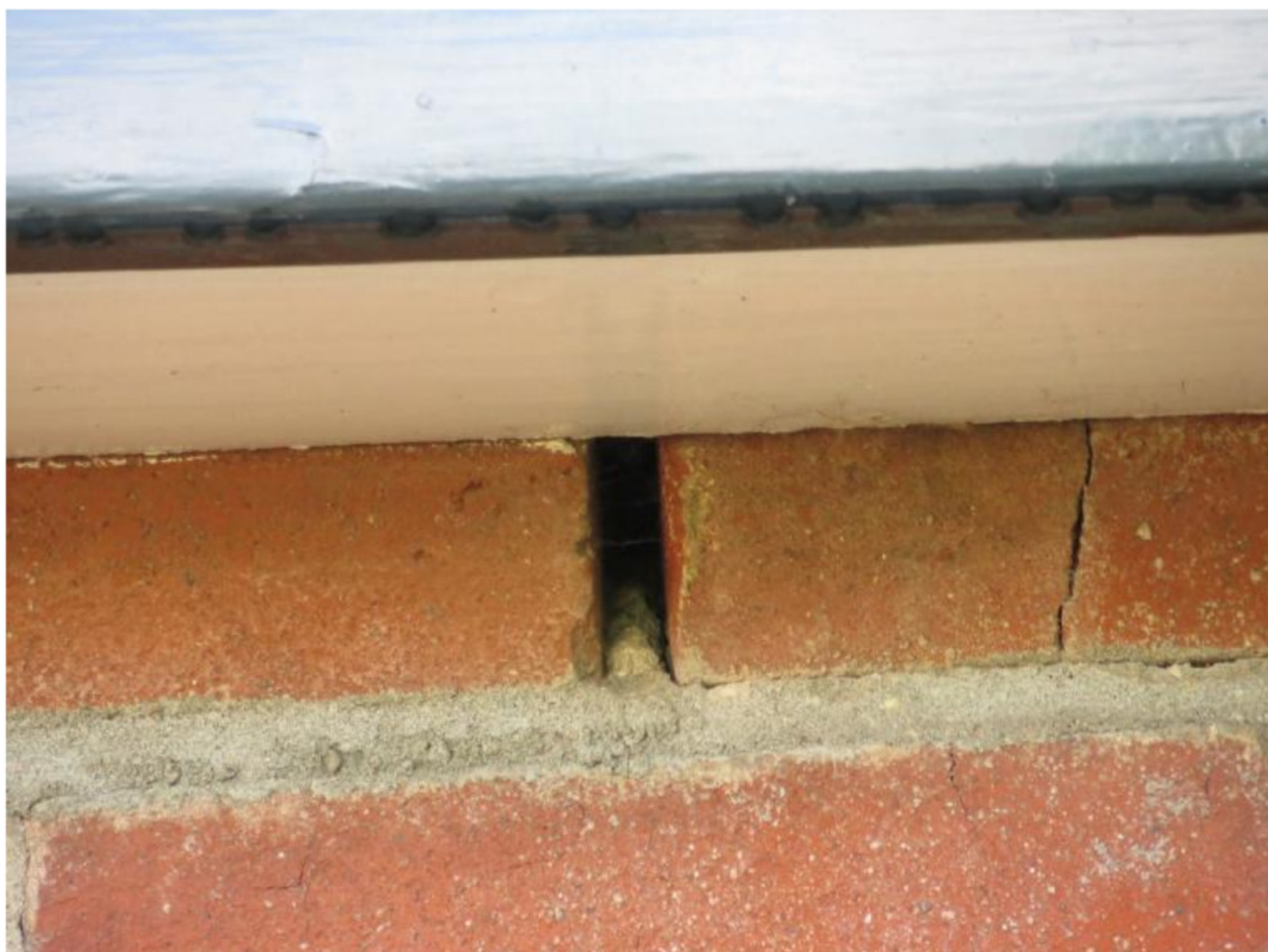
Foto 15: Open stootvoeg (gebouw 5), mogelijke toegang voor vleermuizen.
