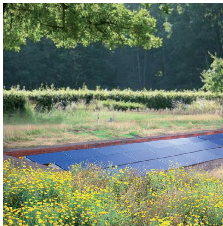
Opstelling zonnepanelen halfverdiept aangelegd en landschappelijk ingepast met een (struweel)haag.
