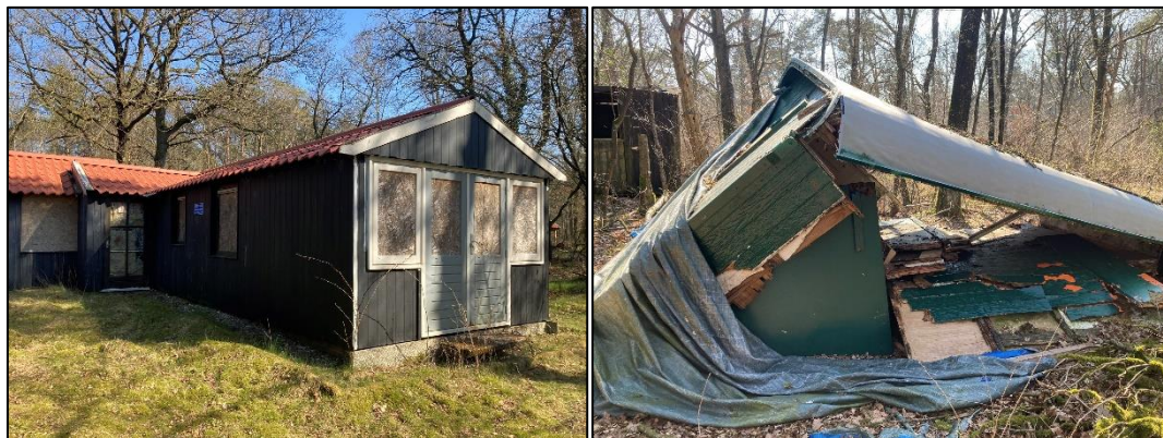
Figuur 2.16 (links): Aanblik op het westelijke deel van de recreatiewoning. Alle deuren en ramen zijn dichtgetimmerd, het dak bestaat uit kunststof panelen; Figuur 2.17 (rechts): Een omgevalen en ingestorte pipowagen.
