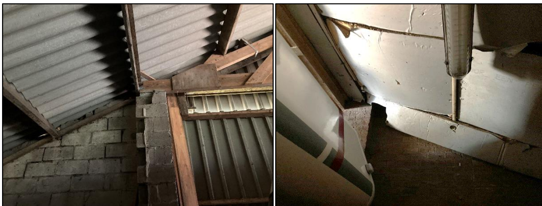
Figuur 2.7 en 2.8: Binnenaanzicht van de schuur. De dakisolatie ontbreekt geheel of heeft erg ruime tochtopeningen.
