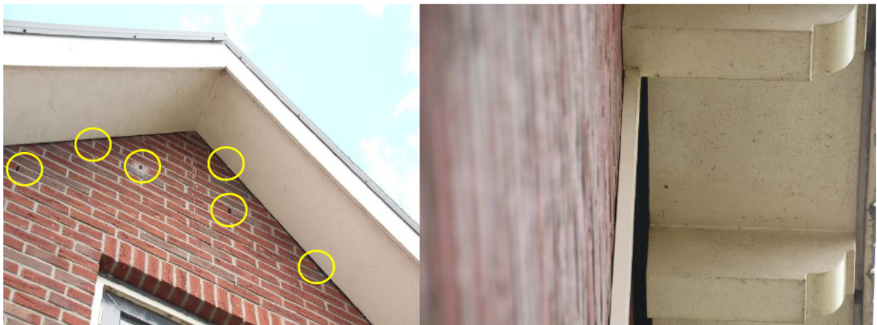
Foto links; Openstootvoegen en kieren tussen de buitengevels en de betimmering van het dakoverstek (gele cirkels). Foto rechts; kieren tussen de houten topgevel en de buitengevels.
