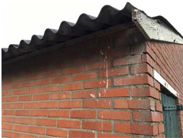
Schijfstrepen op de buitenmuur. Indicatie voor de aanwezigheid van een nestplaats van de spreekw onder de golfplaten.
