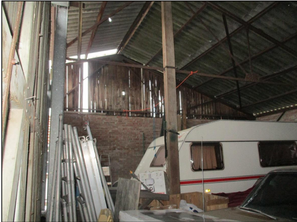
Figuur 4 Schuur A heeft geen dakbeschot en geen binnenwand achter de gevelbetimmering.
