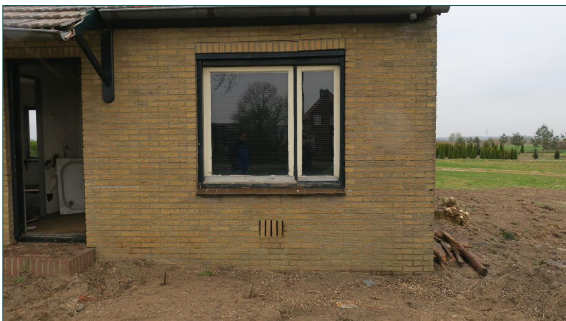
Figuur 2 Er zijn ventilatiegaten aanwezig die toegang bieden tot de spouwmuur. Echter bevinden de ventilatiegaten zich te dicht op de grond om geschikt te zijn gebouwbewonende vleermuizen (<30 cm).
