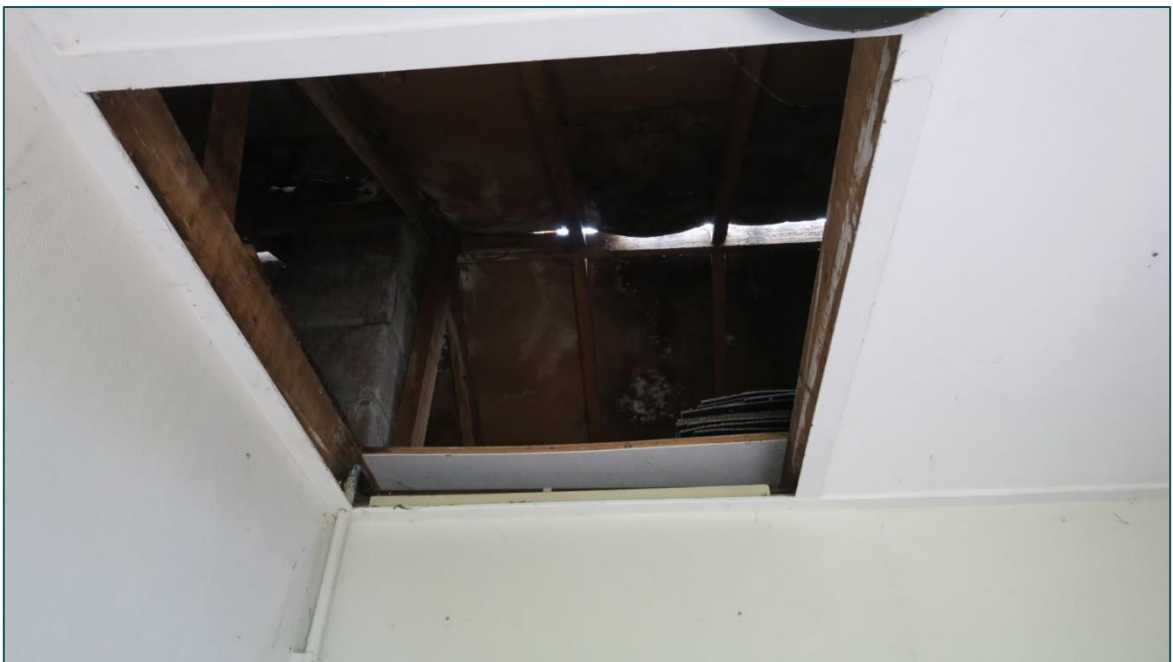
Figuur 4 Langs de nok van het dak is er opening aanwezig naar buiten aanwezig. Hierdoor is het dakbeschot beschadigd door waterschade.
