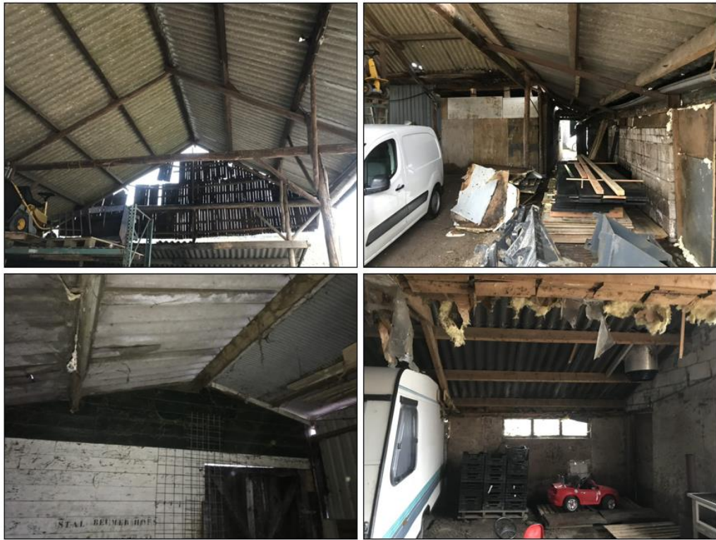
Figuur 3 Fotografische indruk de te saneren bijgebouwen. De bijgebouwen zijn opgebouwd uit enkelwandige muren en voorzien van golfplaten daken zonder dakbeschoot. De bijgebouwen verkeren in een vervalende staat.
