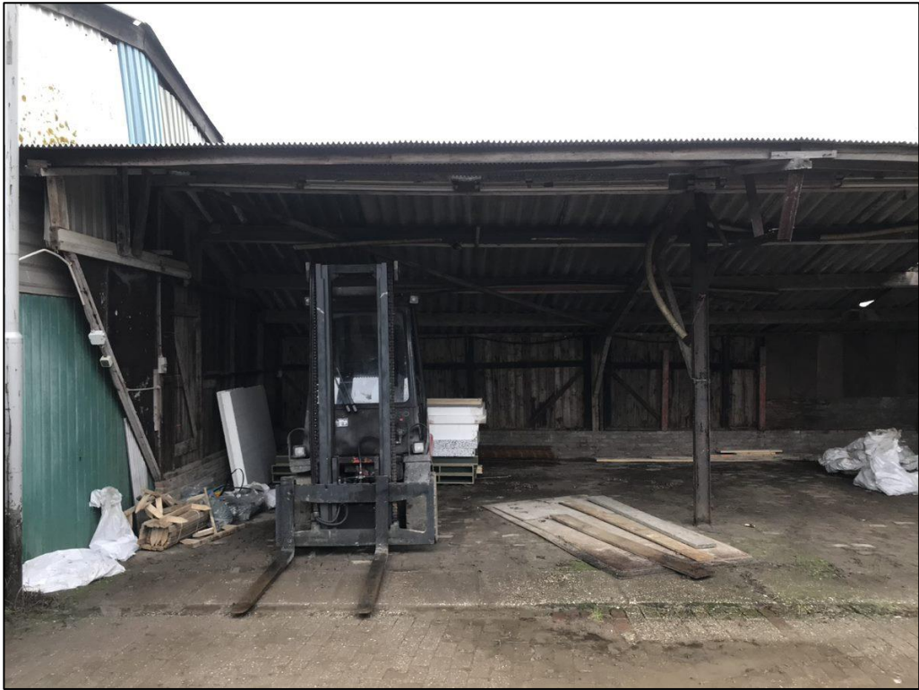
Figuur 3 Bijgebouw op de planlocatie in Dodewaard. Dit bijgebouw wordt gesaneerd.
