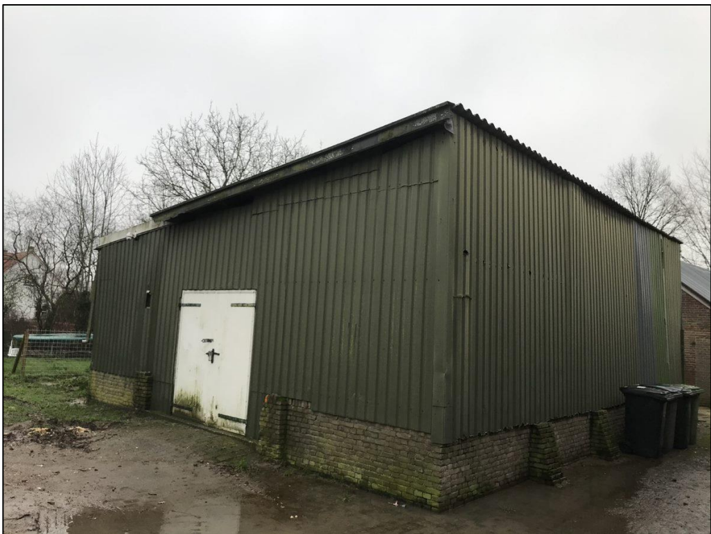
Figuur 6 Bijgebouw 3 op de planlocatie in Dodewaard. Dit bijgebouw wordt gesaneerd.
