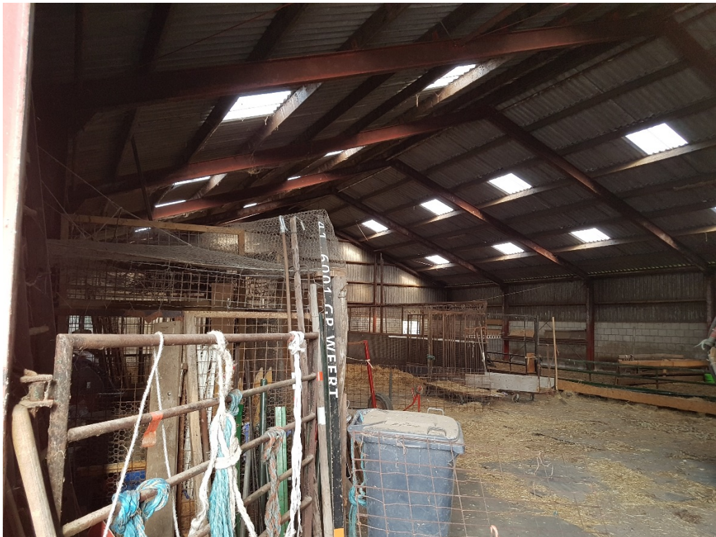
Figuur 2 De schuur is niet meer in agrarische functie en wordt gebruikt voor opslag van materiaal.
