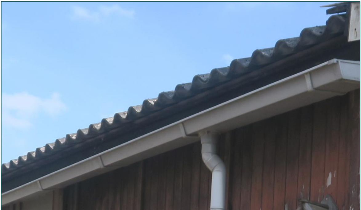
Figuur 3.4 Er is geen vrije aanvliegroute aanwezig in gebouw B, gezien er een dakgoot voor de opening tussen het dakbeschot aanwezig is.
