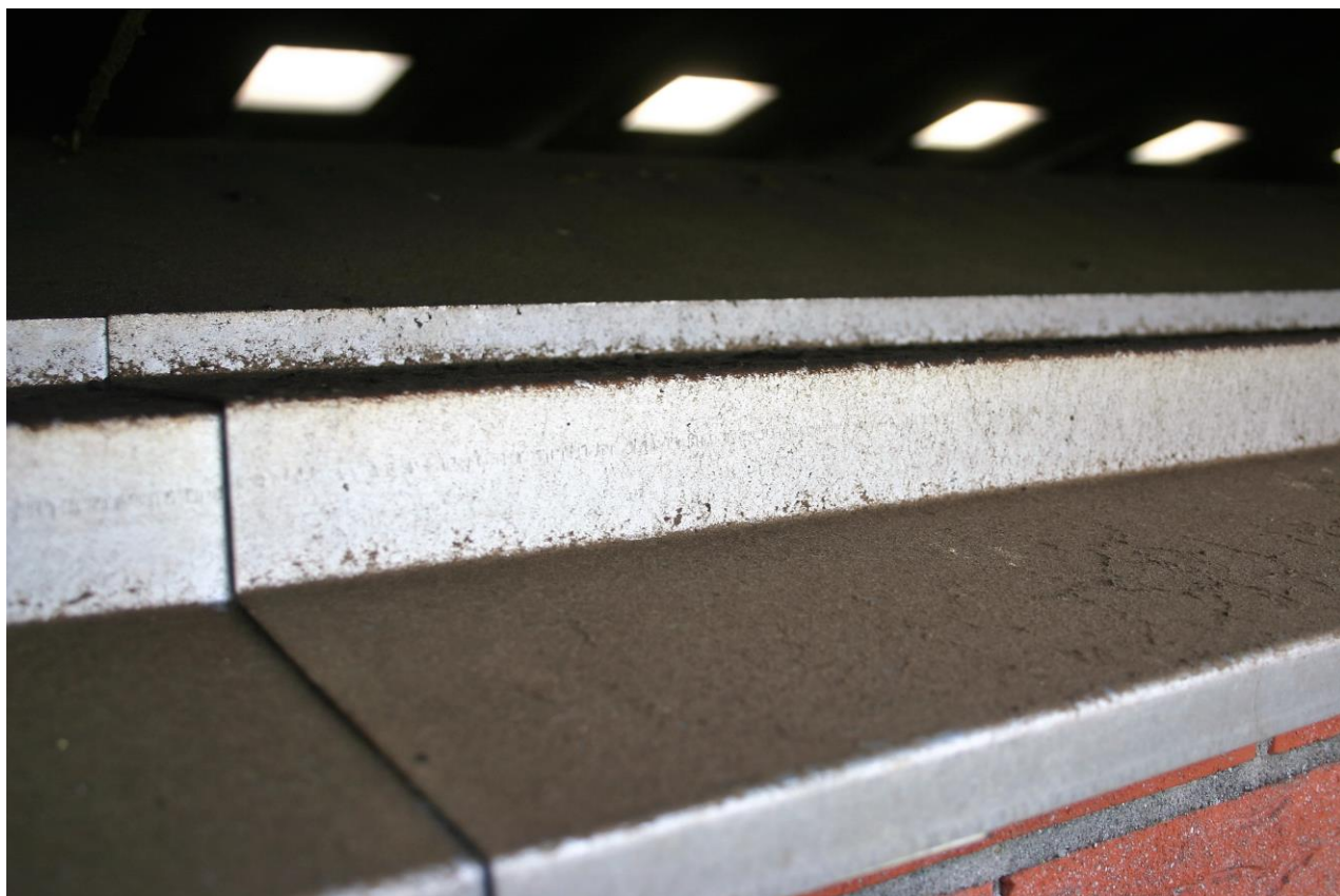
Figuur 4.5.4. De aluminium platen op de bovenkant van de muren van de grupstal.
