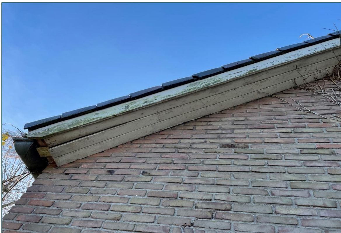
Figuur 3 Vleermuizen kunnen via diverse delen toegang tot de spouw en dakruimte krijgen, namelijk de kierende kantpannen, losse rabat delen van het overstek en ruimte tussen gevel en overstek.
