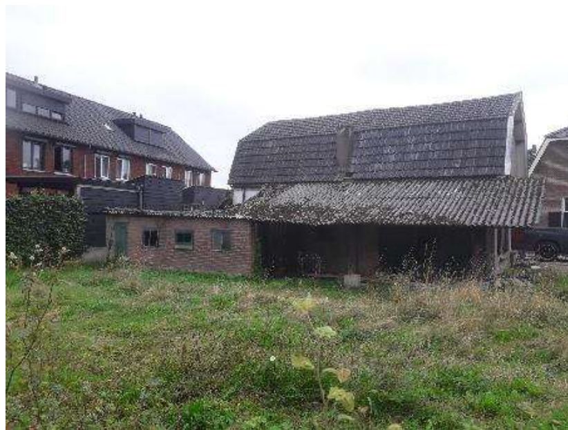
Foto 4: Aanwezige schuur met overkapping en asbestverdachte dakbedekking, zonder dakgoot uitkomend op onverhard terreindeel.
