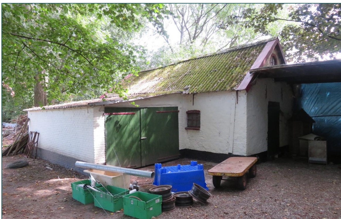
Figuur 2 De schuur bestaat uit enkelsteens muren met een golfplaten dak zonder dakbeschot.
