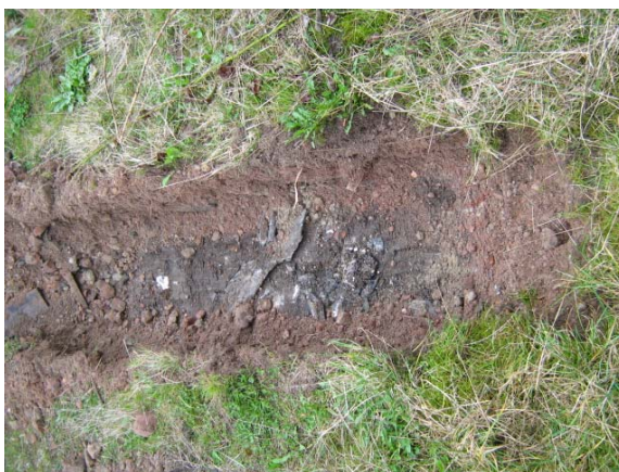
Foto 5: Inspectiesleuf 5 (met op de bodem asbestverdacht materiaal)
