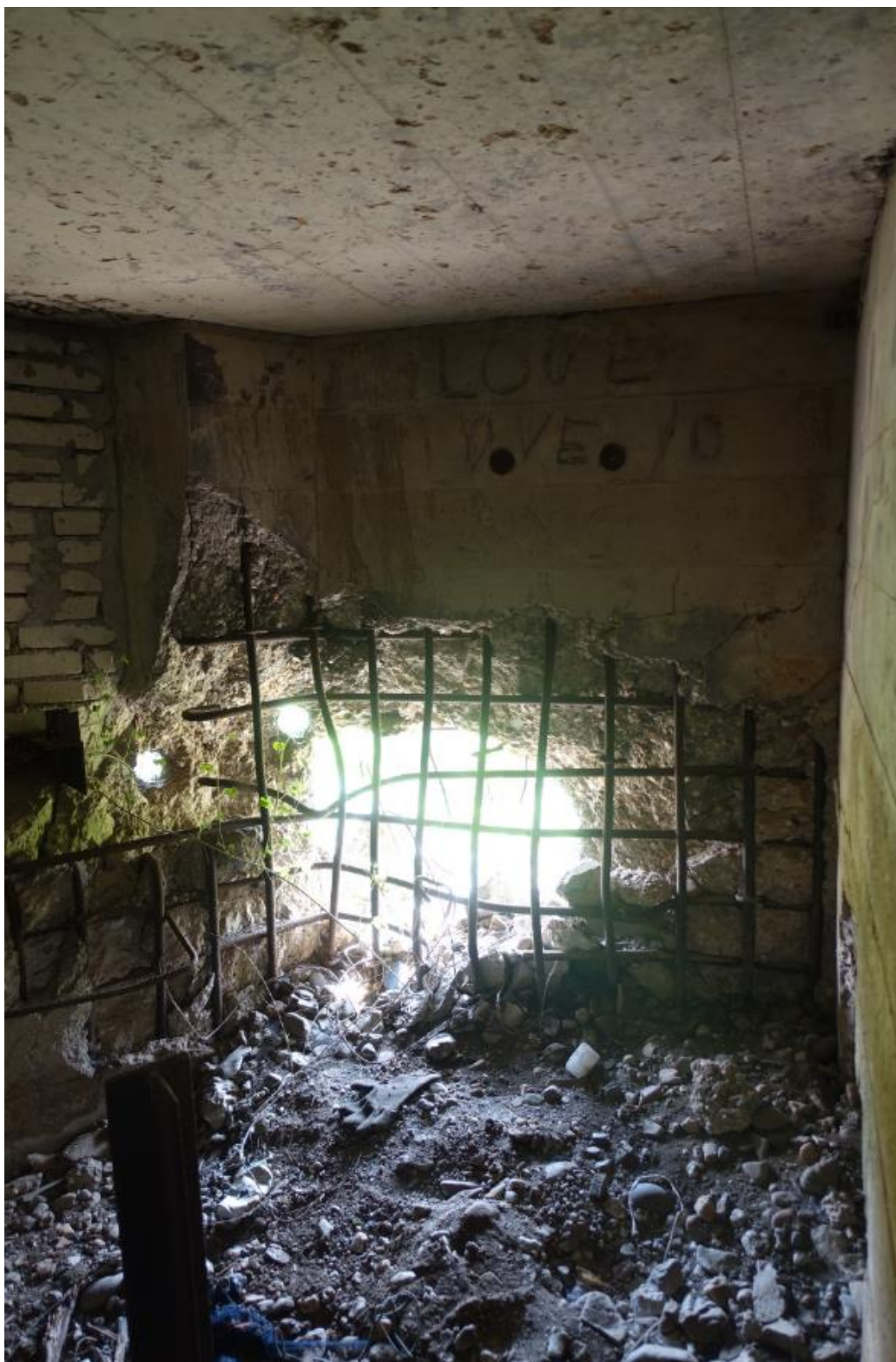
Afb. 42 Interieur oostelijke kazemat met zicht op de zuidelijke zijgevel. De gevel is links onder door een treffer op de wapening na geheel weggeslagen. Ook zijn twee ronde inslaggaten zichtbaar waardoor granaten in de kazemat zijn gedrongen. In het plafond is de wapening deels zichtbaar geworden. Hier zijn echter geen bevestigingen voor ophanging van de afzuiging te zien. Wel zijn in de zijgevel twee bevestigingspunten aanwezig. FH MAB 2021
