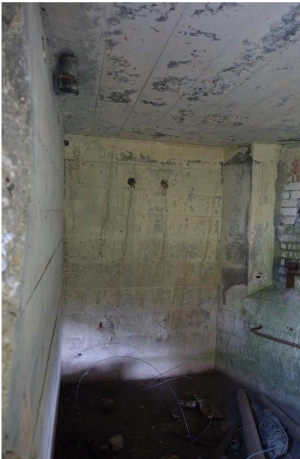
Afb. 41 Interieur oostelijke kazemat met zicht op de noordelijke zijgevel. Rechts is nog net het linker schietgat zichtbaar met de beugel voor de voeten van de schutter. In het plafond is de wapening deels zichtbaar geworden. Hier zijn echter geen bevestigingen voor ophanging van de afzuiging te zien. Wel zijn in de zijgevel twee bevestigingspunten aanwezig en links boven in het plafond ijzeren buizen van een afzuiging. FH MAB 2021
