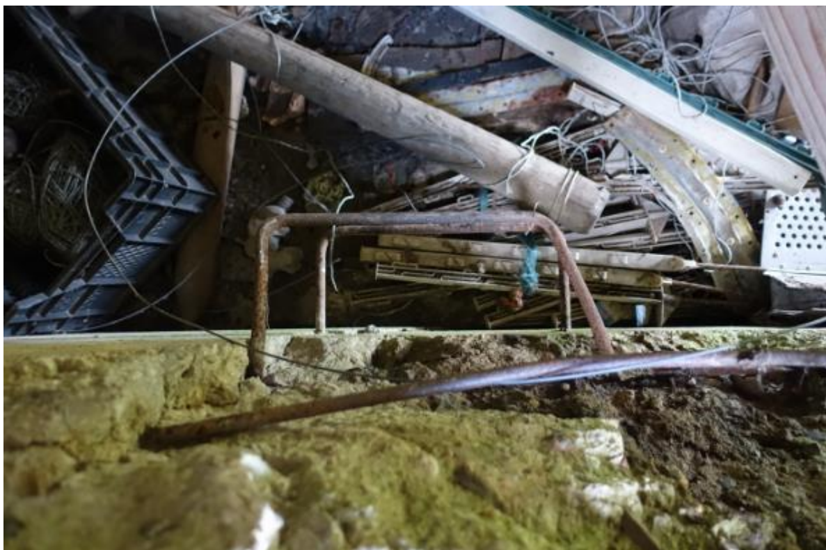
Afb. 44. De met puin en rommel bezaaide vloer onder de entree in de achtergevel. De ijzeren trapbeugels van de entree zijn nog aanwezig. FH MAB 2021
