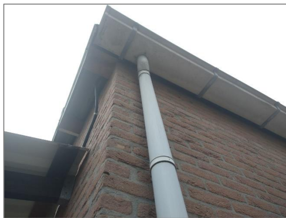
Afbeelding 4.9 | Opening onder dakrand op hoek van schuur A achter dakgoot
