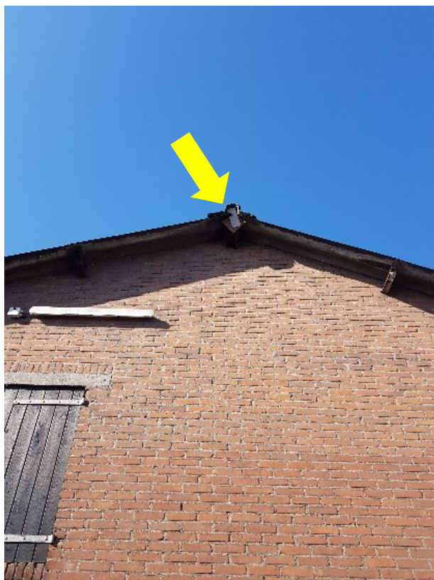
Figuur 5: Openingen bij de nokvorst aan de oostelijk zijde van de centrale schuur.
