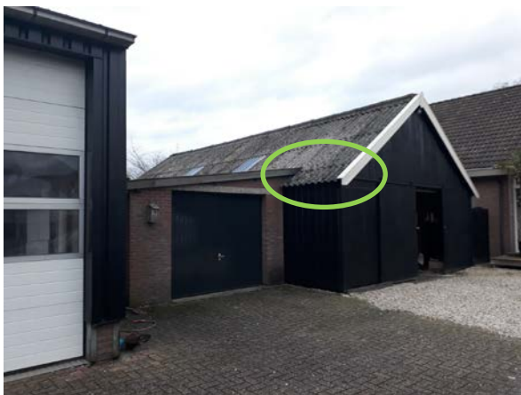
Foto 1: Asbestverdachte dakbedekking zonder dakgoot. Deze watert af op een klinkerverharding.
