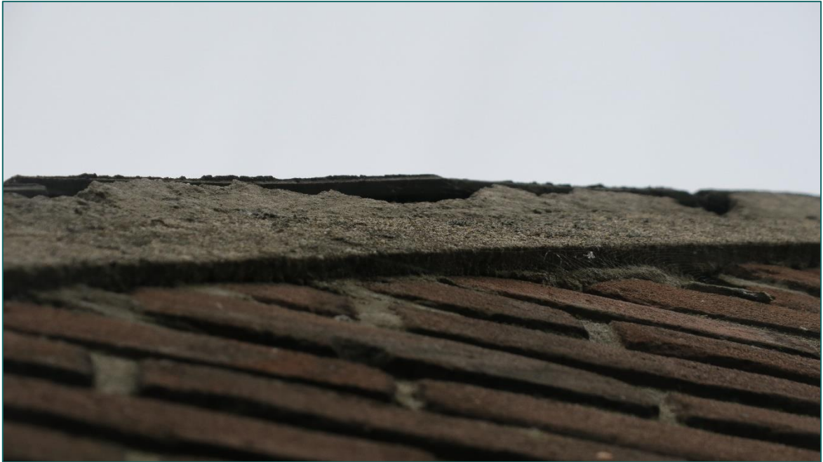
Figuur 3.3 Kierende kantpannen van de woning welke gierzwaluwen de gelegenheid bieden de dakruimte te betreden.
