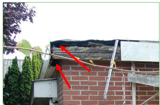
De gaten in de boeiboorden (rode pijlen) bevestigd aan de noord-, oost- en zuidgevel van de voormalige burgemeesterswoning geven mogelijk toegang tot voor Huismussen geschikte achterliggende ruimtes.
