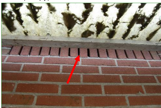
Deze open stootvoegen (rode pijl) in de noordgevel van de bebouwing (voormalige burgermeesterswoning), geven mogelijk toegang tot voor vleermuizen geschikte achterliggende ruimtes.
