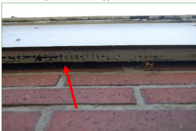
Spleten, gaten en kieren achter de boeiboorden van de voormalige burgermeesterswoning, geven mogelijk toegang tot voor vleermuizen geschikte achterliggende ruimtes (rode pijl).
