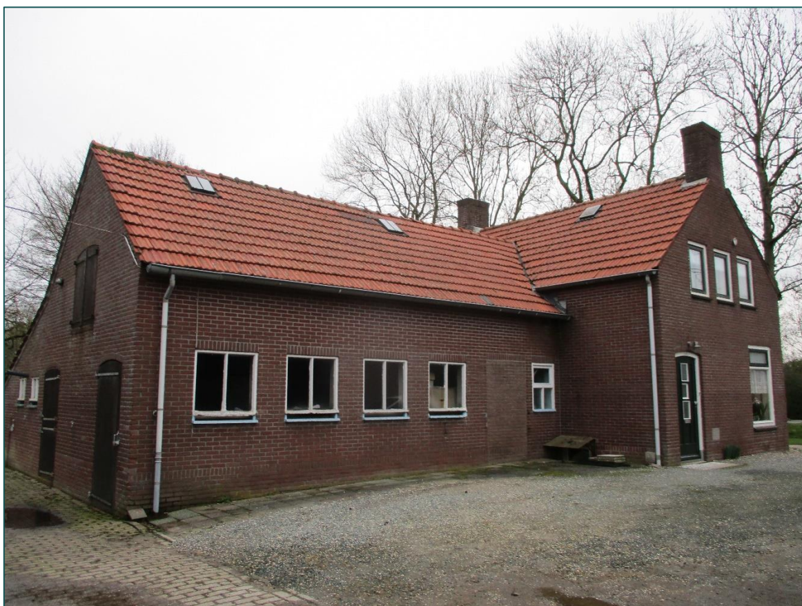
Figuur 4 Het aangebouwde gedeelte (links) van de woning heeft geen spouwmuur.
