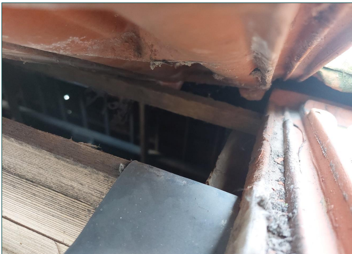
Figuur 5 In de hoge delen van de aanbouw van de woning ontbreekt het aan dakbeschot.
