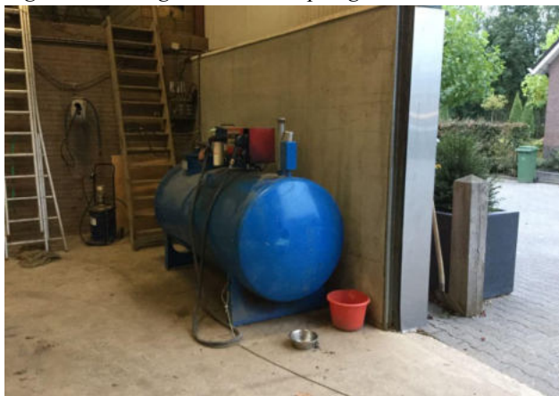
Figuur 1: bovengrondse dieselopslag
