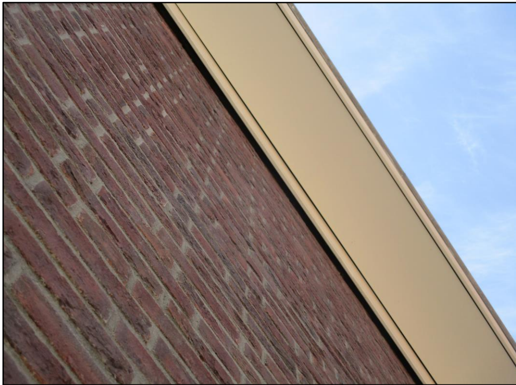
Figuur 1.3 Middels toegankelijke kieren onder de omlijsting van de dakgoot kunnen vleermuizen toegang krijgen tot binnenruimtes waardoor potentie voor (in dit geval) vleermuizen niet uitgesloten kan worden.
