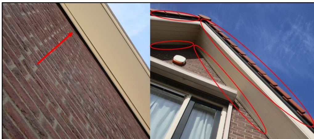
Figuur 4 Kierend boeiboord langs de gevels van de PLUS supermarkt en kierende kantpannen en dakoverstek van het woonhuis aan de Stationsstraat 5.
