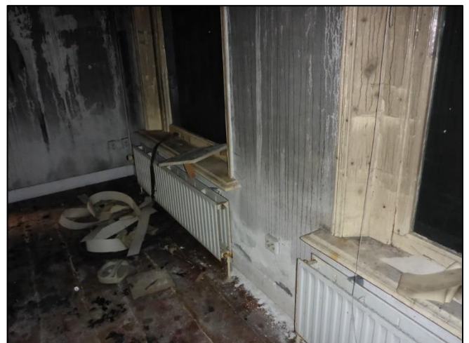
Foto 36: Begane grond: Radiatoren (Asbestvrij)
