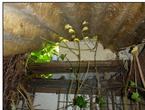
Bijgebouw, Aanbouw: Golfplaten dak (M04AA)
