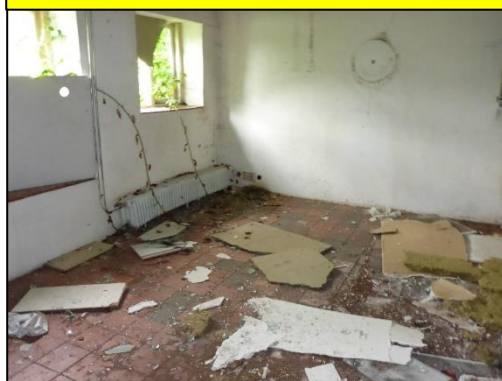
Bijgebouw: Pakking in lamellen radiator (M03AA)
