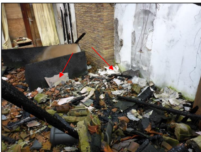
Foto 23: Boerderij, Begane grond: Restanten plafondbeplating (M01AA)
