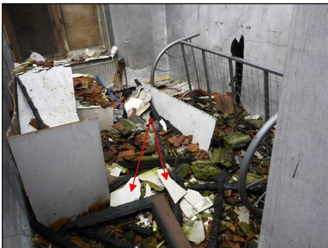
Foto 15: Boerderij, Begane grond: Restanten plafondbeplating (M01AA)
