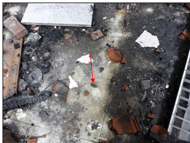
Foto 18: Boerderij, Begane grond: Restanten plafondbeplating (M01AA)
