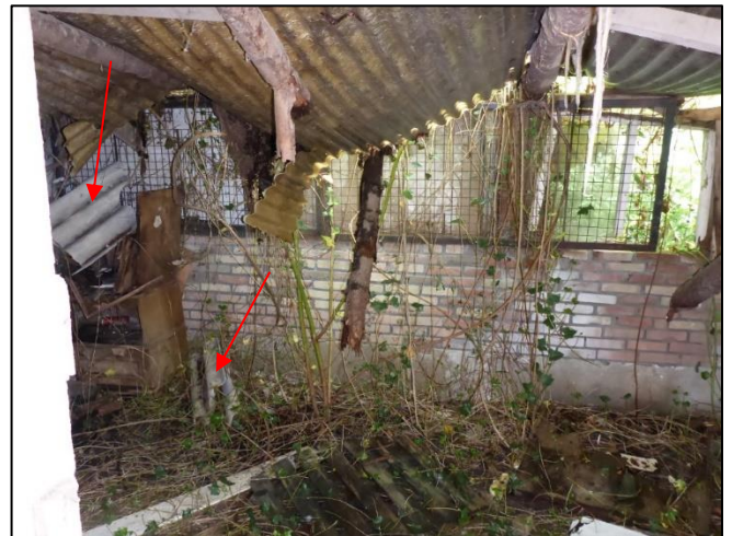
Foto 70: Bijgebouw, Aanbouw: Restanten golfplaten dak (M04AZ)
