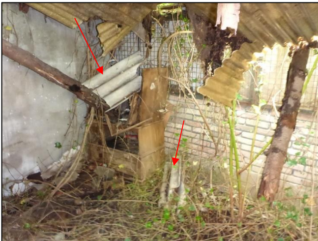
Foto 69: Bijgebouw, Aanbouw: Restanten golfplaten dak (M04AZ)
