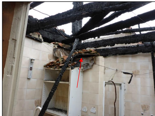
Foto 22: Boerderij, Begane grond: Restanten plafondbeplating (M01AA)
