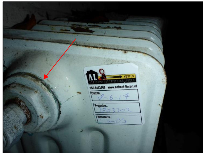
Foto 62: Bijgebouw: Pakking in lamellen radiator (M03AA)
