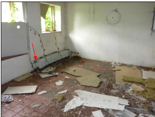
Foto 63: Bijgebouw: Pakking in lamellen radiator (M03AA)
