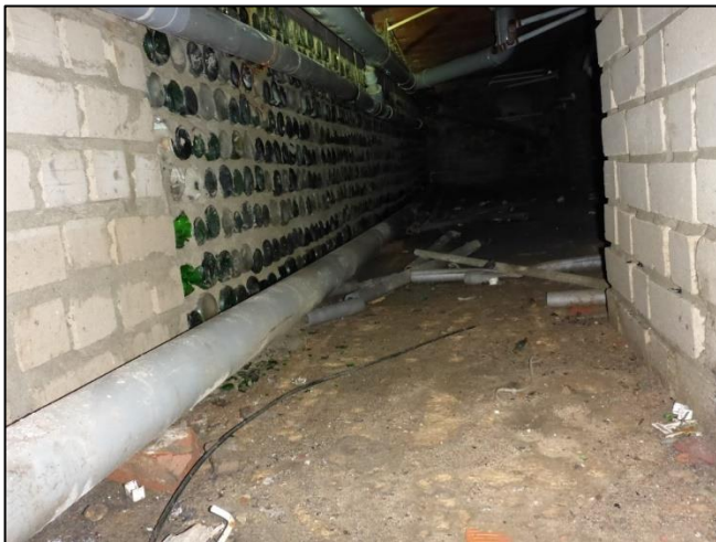
Foto 43: Kelder: Buizen en leidingen (Asbestvrij)
