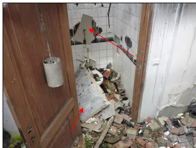
Foto 24: Boerderij, Begane grond: Restanten plafondbeplating (M01AA)
