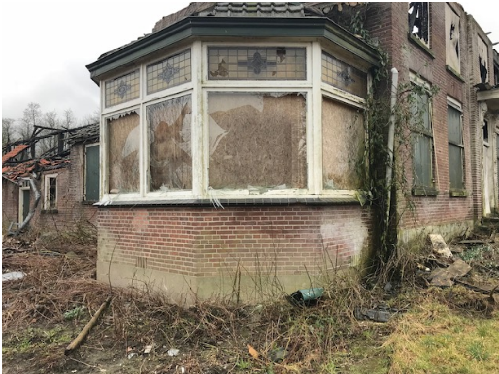
Figuur 3 Als gevolg van de brand is er niet veel overgebleven van het dak.
