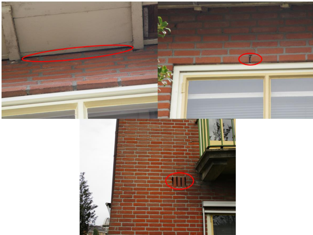
Figuur 2 Potentiële invliegopeningen voor vleermuizen in de vorm van kierende daklijsten, ontbrekende specie en ventilatievoegen.
