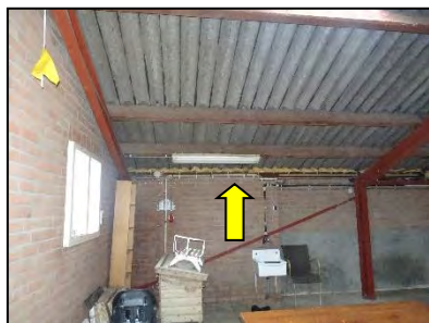
Figuur 13. Binnenkant schuur, ruimte onder het golfplaten dak is ontoegankelijk gemaakt.
