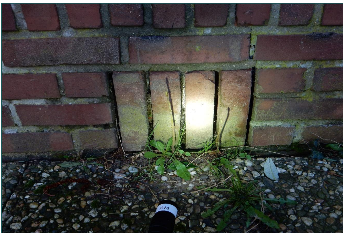
Figuur 2 De spouwmuur is naderhand geïsoleerd met EPS isolatiekorrels.
