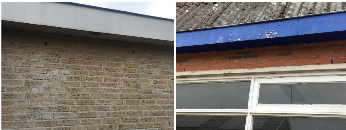
Open stootvoegen in bebouwing aan de Van Kollaan (links) en de Roerdompstraat (rechts). Vleermuizen kunnen een verblijfplaats bezetten in de luchtspouw, via deze openingen.
