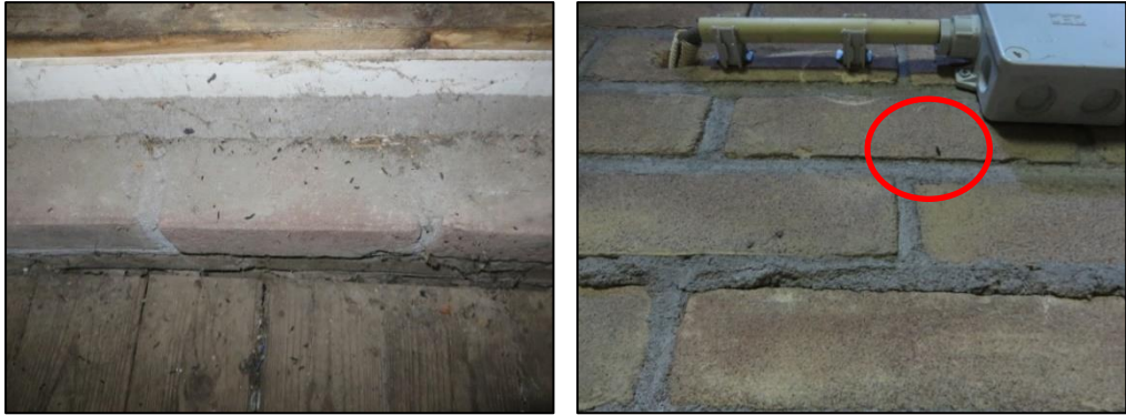
Van links naar rechts: Vleermuisuitwerpselen op de zoldervloer en vleermuisuitwerpselen op de zoldermuur van gebouw 2. Foto's: SAB.
