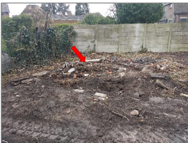
Foto 5: Materiaal op het maaiveld noordoostelijke hoek (asbestverdachte standleiding)
