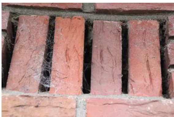
Ventilatieopening vol met spinrag. Aanwijzing van dat vleermuizen geen gebruik maken van deze openingen om de spouw te bereiken.
