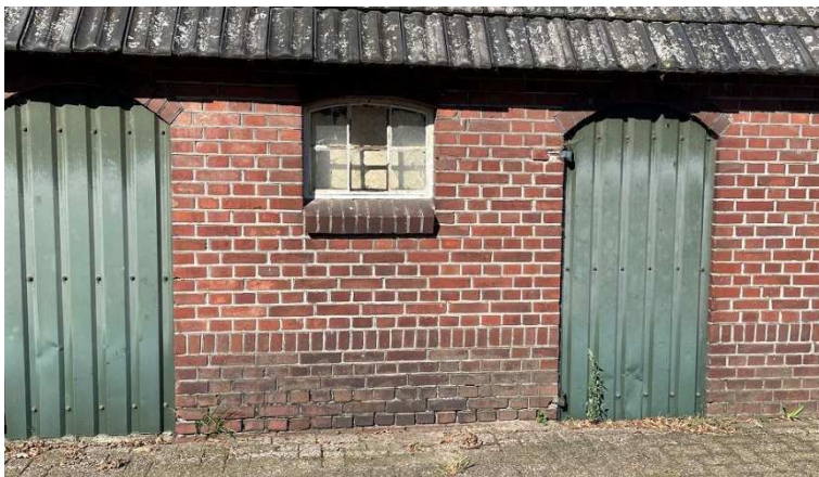
Foto: voegwerk in trasraam
