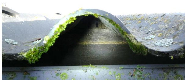
Figuur 17: Vogelschroot aanwezig onder de golfplaten
