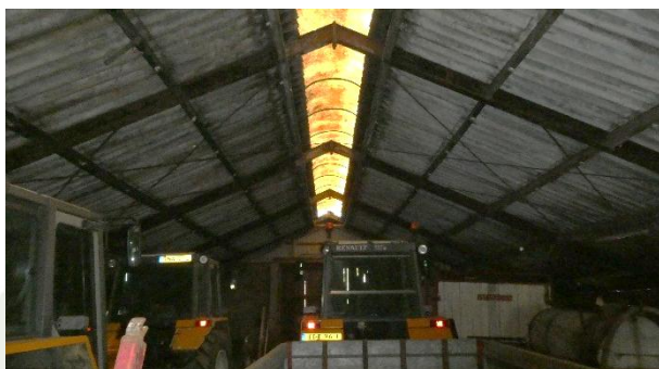
Figuur 16: Constructie niet geschikt bevonden als nestlocatie van huismus
