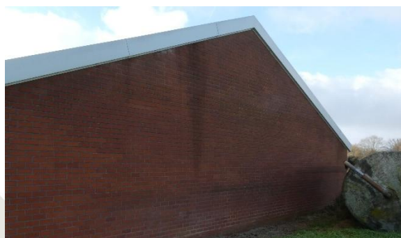
Figuur 21: Het ontbreekt de opstallen aan geschikte openingen in de gevels.
