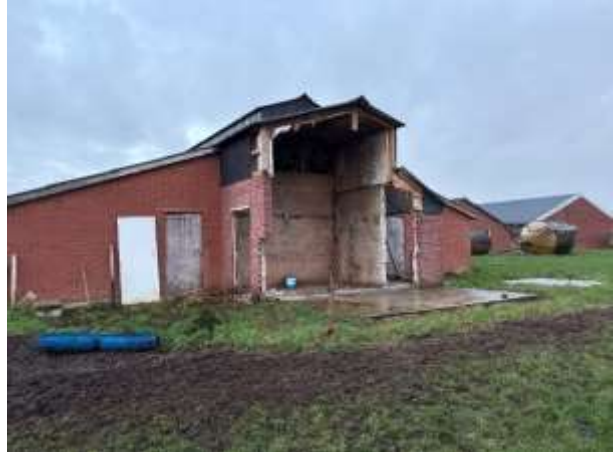
Figuur 10: Vml. locatie luchtwasser
